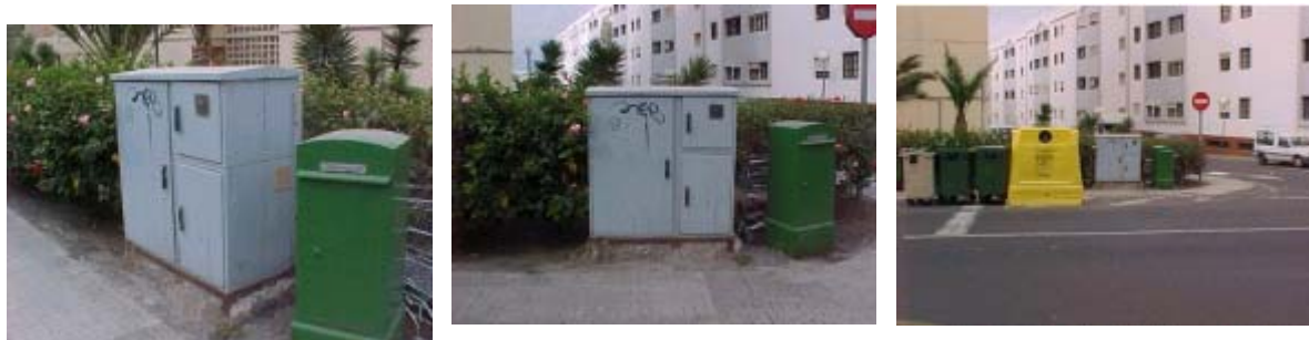
Figura 5. Armario de nodo final (AR-008)
